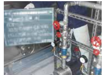
配管の老朽化
